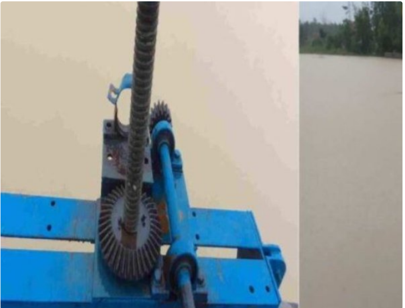
Pintu air Albaret Simpang Mesuji
